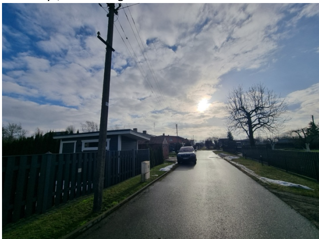
Inžineriniai tinklai - 0,38 kv elektros oro linija nuo atramos 100/1 iki atramos 100/4, tarp atramų 100/4-100/7, ir nuo
